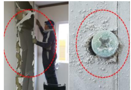
③ 시공 품질 및 외관 저하 실리콘 작업시 전량폐기, 부분교체 불가
