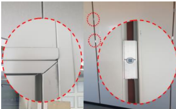
① 피스 고정에 따른 결합력 저하 건물진동, 사람움직임, 충격에 따른 피스 고정력 약화와 패널 변형
